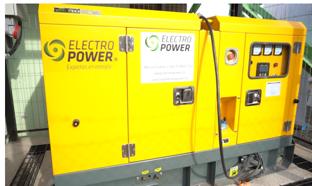
IMAGEN 21 GRUPO ELECTRÓGENO APR COMALLE
